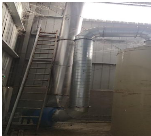
待宰车间和污水处理站废气处理
