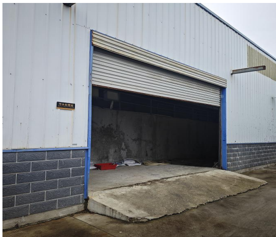
污水处理站全密闭
